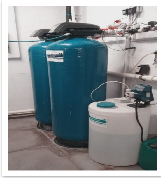
Su Yumuşatma Sistemi
